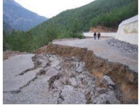
Yer kayması sonucunda yolda oluşan çatlaklar
