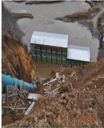
Sel suları altında kalmış santral binası
