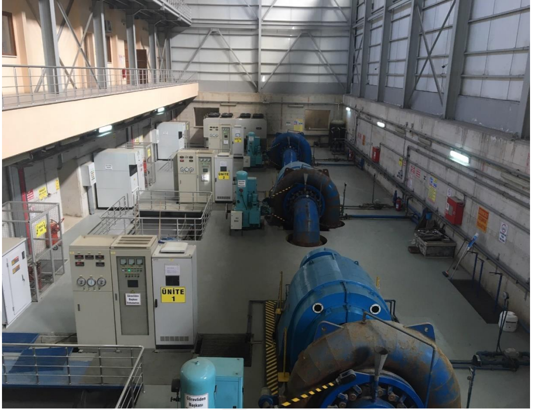
Şekil 21 Santral Binası ve Türbinler
