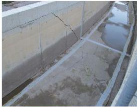
Yer kayması ve oturma neticesinde iletim kanalında oluşan çatlaklar
