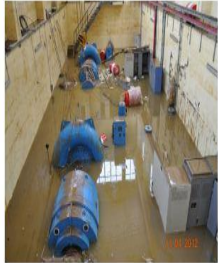
Sel suları altında kalmış türbin holü
