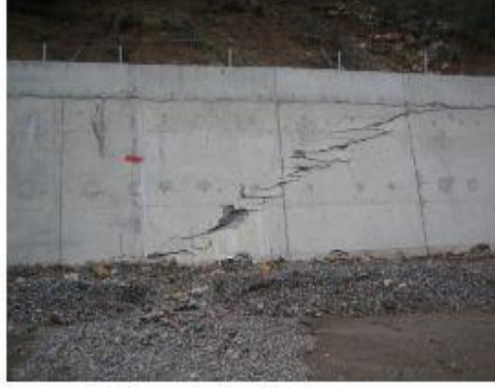
Oturma neticesinde hasarlanmış istinat duvarı
