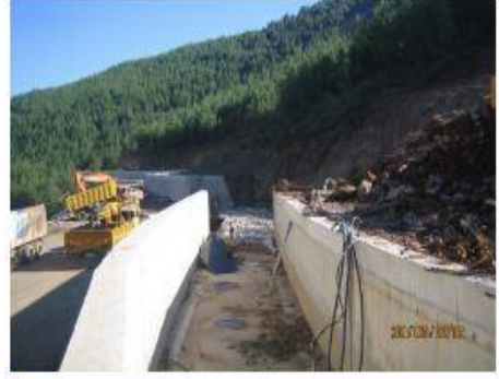
Toprak kayması neticesinde hasarlanmış iletim kanalı
