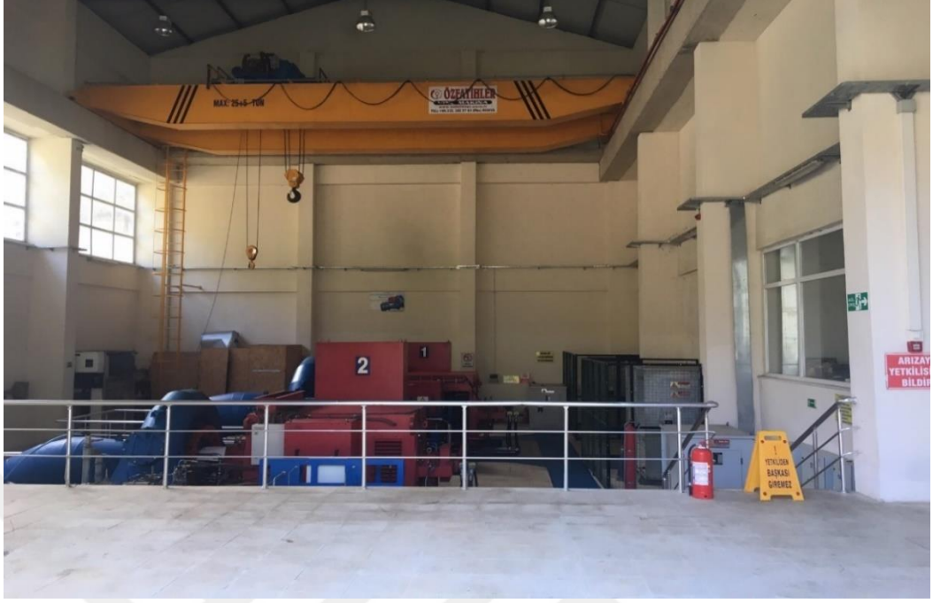
Şekil 12 Santral Binası ve Türbinler
