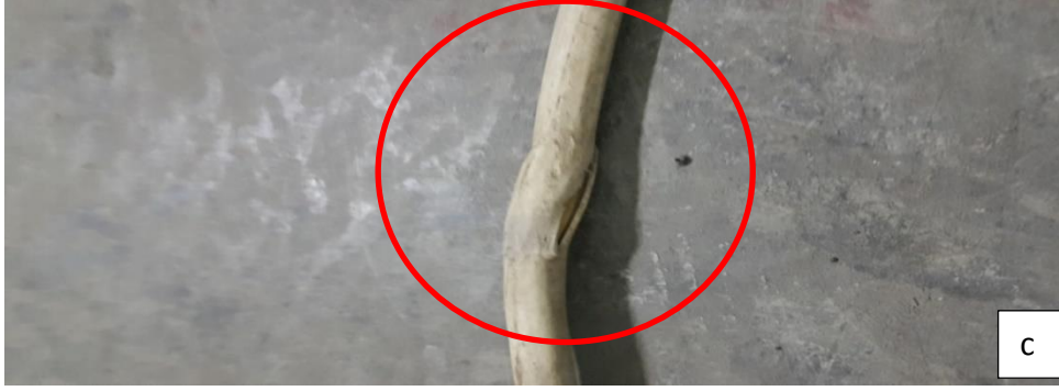
Fotoğraf 28:Çalışanın, a) Anahtar Kısmını Sökmesi, b) ve c) Kullandığı Deformasyona Uğramış Uzatma Kablosu
