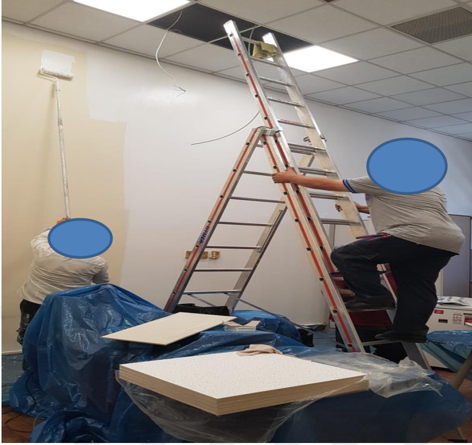
Fotoğraf 9:Elektrik ve Boya İři Yapan alıřanların Aynı Ortamda Bulunması
