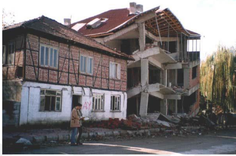
Şekil 5:1999 Depremlerinden Sonra Kaynaşlı’da Geleneksel ve Betonarme Yapıların Hasar Görmüş Durumları (Doğangün, A., Livaoğlu,R.,Tuluk, İ.,Acar,R.,2005).
