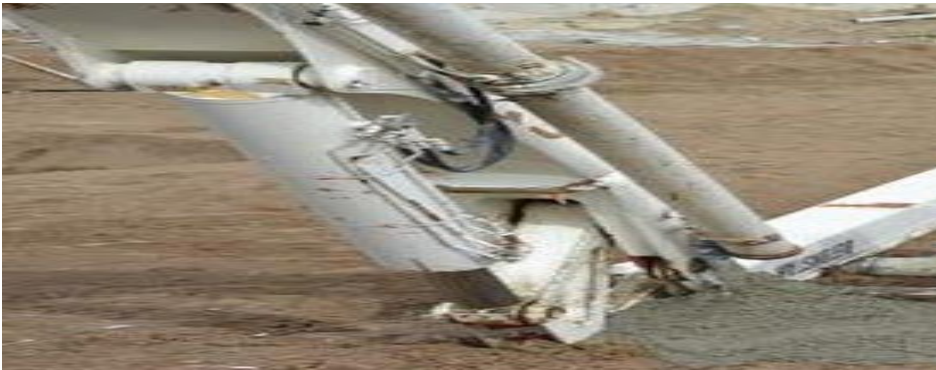
Şekil 16 Mobil Beton Pompası Ölümlü Kaza[36]
