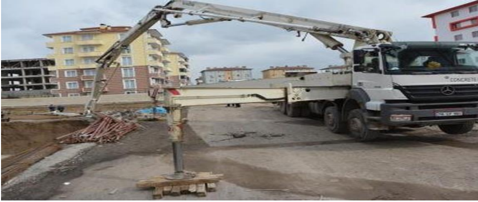
Şekil 15 Mobil Beton Pompası Ölümlü Kaza[36]
