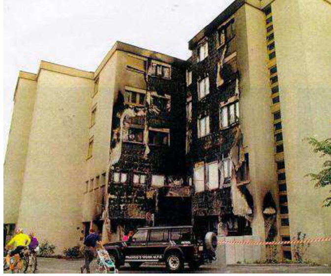
Resim 2.3:Apartment Building. Yanıcı cephe kaplamasının çöp varilinden alevi alması sonucu cephe yangını oluşmuştur [35].
