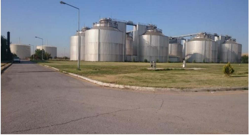
Şekil 6. 128 : Digester Ve Biyogaz Sahası
