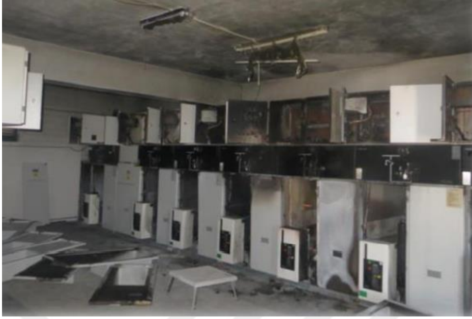
Şekil 6. 31 : İnverter Ekipmanının Hasar Görünümü
