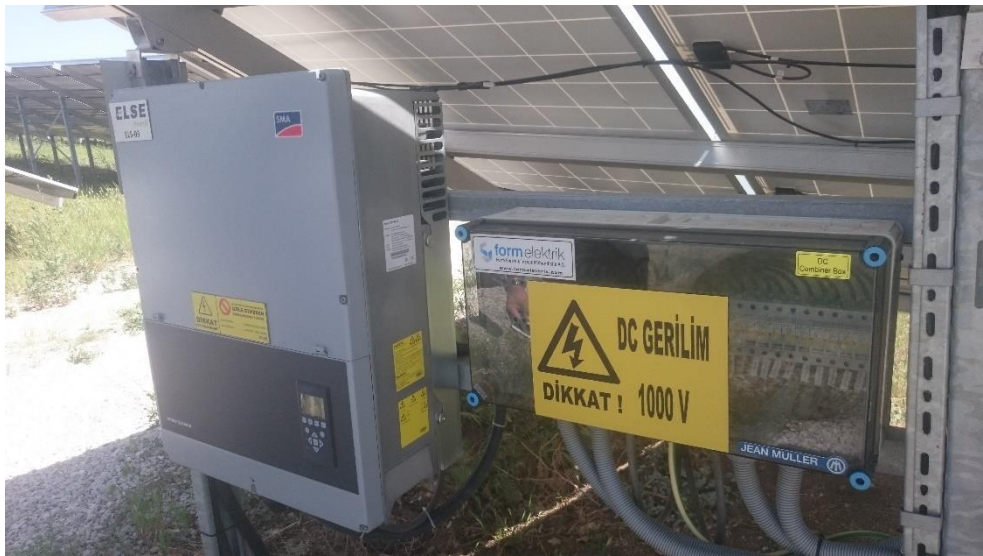
Şekil 6. 19 : İnverter ve Combiner Box
