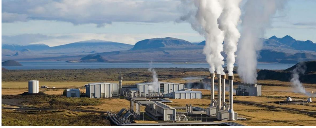
Şekil 6. 91 : Jeotermal Sahası Genel Görünümü
