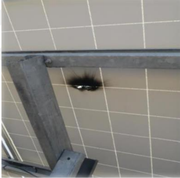
Şekil 6. 32 : Fotovoltaik Panelin Hasar Görünümü
