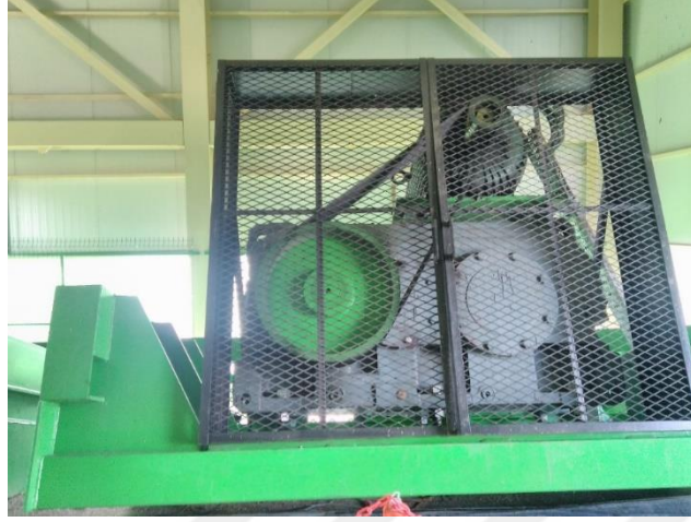
Şekil 6. 86 : Türbin Miline Bağlı Asenkron Motor Görünümü
