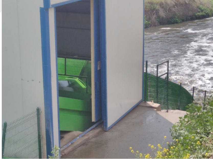
Şekil 6. 85 : Tatlar Su Arıtma Merkezi Hidroelektrik Enerji Santral Görünümü
