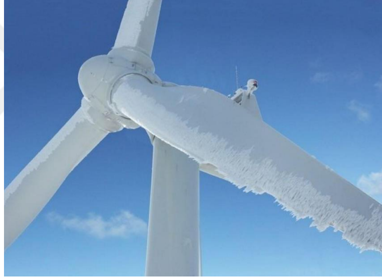
Şekil 6. 51 : Türbin Üzerinde Meydana Gelen Buzlanma
