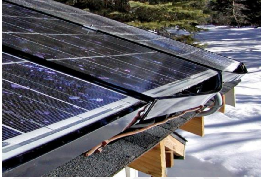
Şekil 6. 33 : Genleşme Sonucu Oluşan Panel Hasar Görünümü
