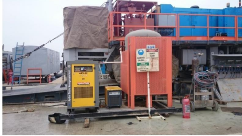
Şekil 6. 104 : Hava Kompresör Tankı
