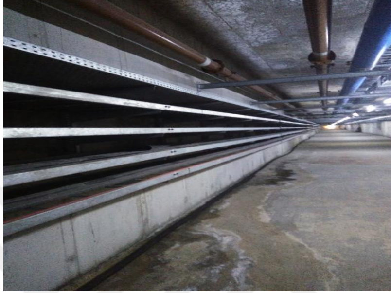
Şekil 6. 137 : Yer Altından Digester Kısımına Ulaşan Boruların Görünümü
