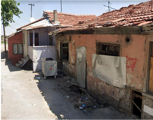
Şekil 133: Kale Mahallesi 2. Sokak Çevresel Kirlilik ve Yapısal Durum (Google Haritalar Sokak Görünümü 2021)
