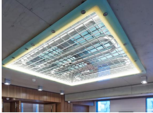
Şekil 4.5: Türkiye Mühendisler Birliği Binası Termal Beton Döşeme (TMB 2022)
