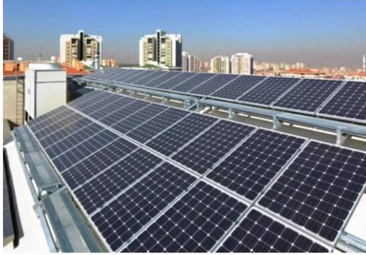
Şekil 4.8: Türkiye Mütcahitler Birliđi Binası Fotovoltaik ve Solar Paneller (TMB 2022)
