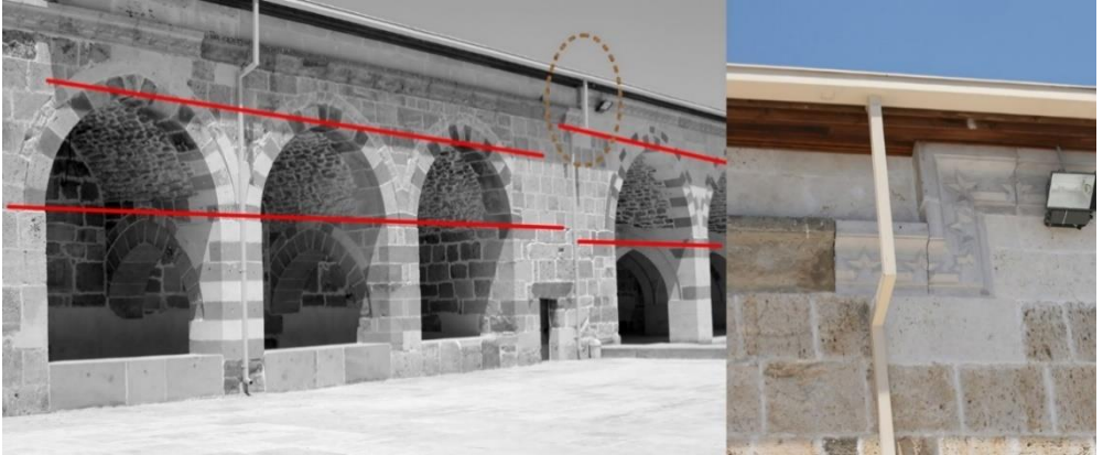
Sekil 8: Sadeddin Han, 2008 yılı onarım sonrası itibarıyla, avlu güney cephesinde tonoz alınlarında kot farklılıkları
