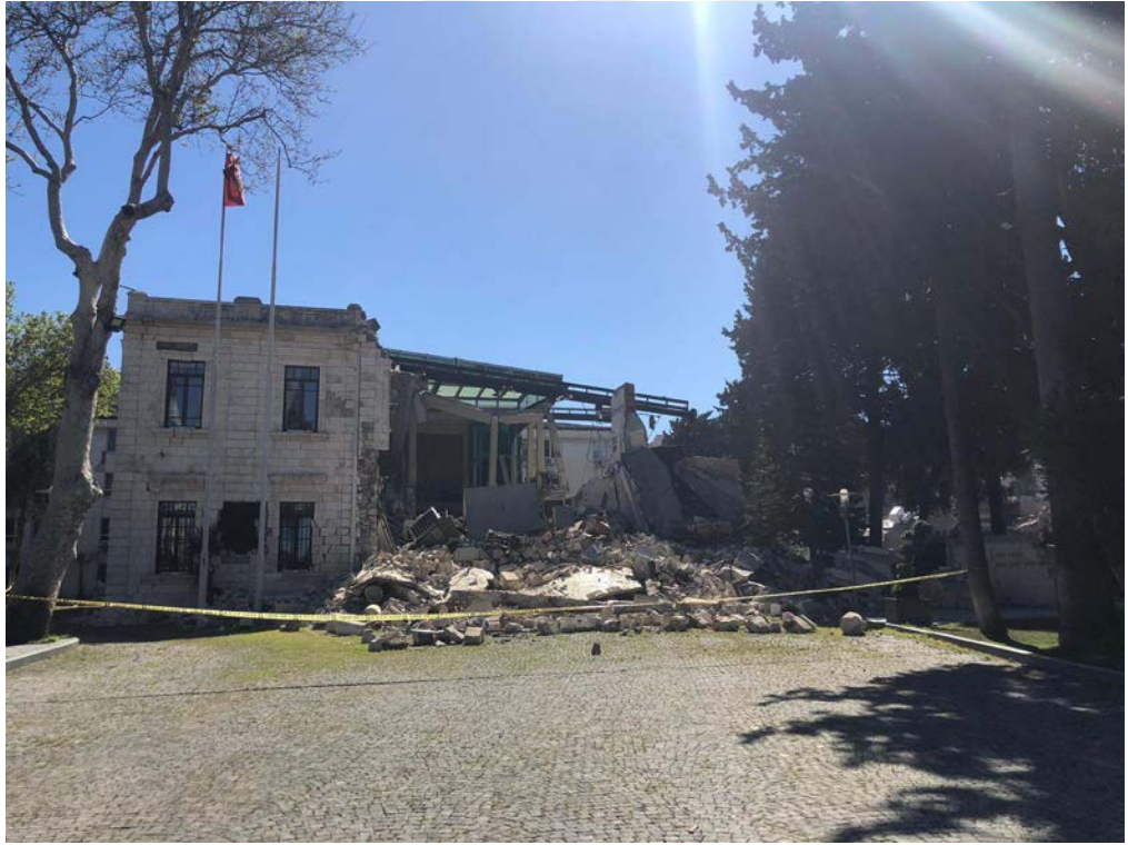
Şekil 6.10: Valilik Binası (Depremden Sonra)
