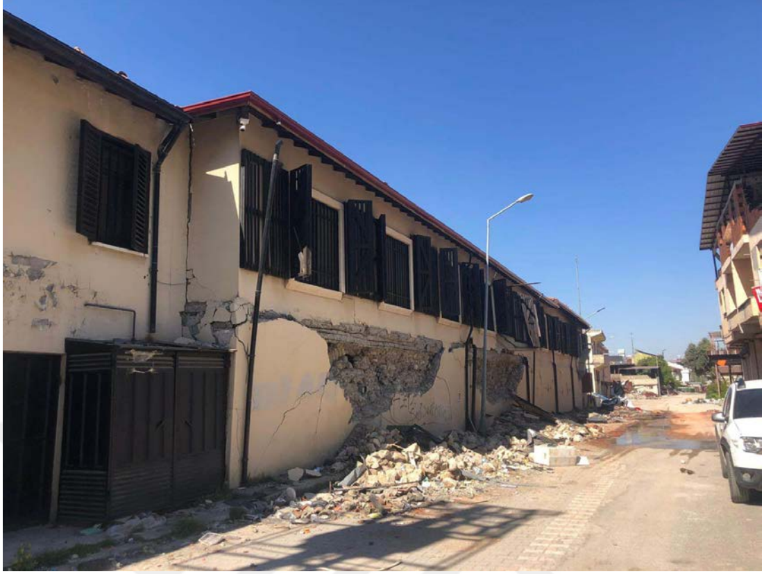
Şekil 6.19: Savon Otel (Depremden Sonra)
