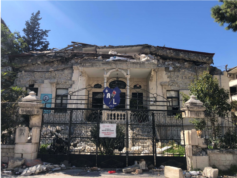
Şekil 6.8: Ata Lisesi (Depremden Sonra)
