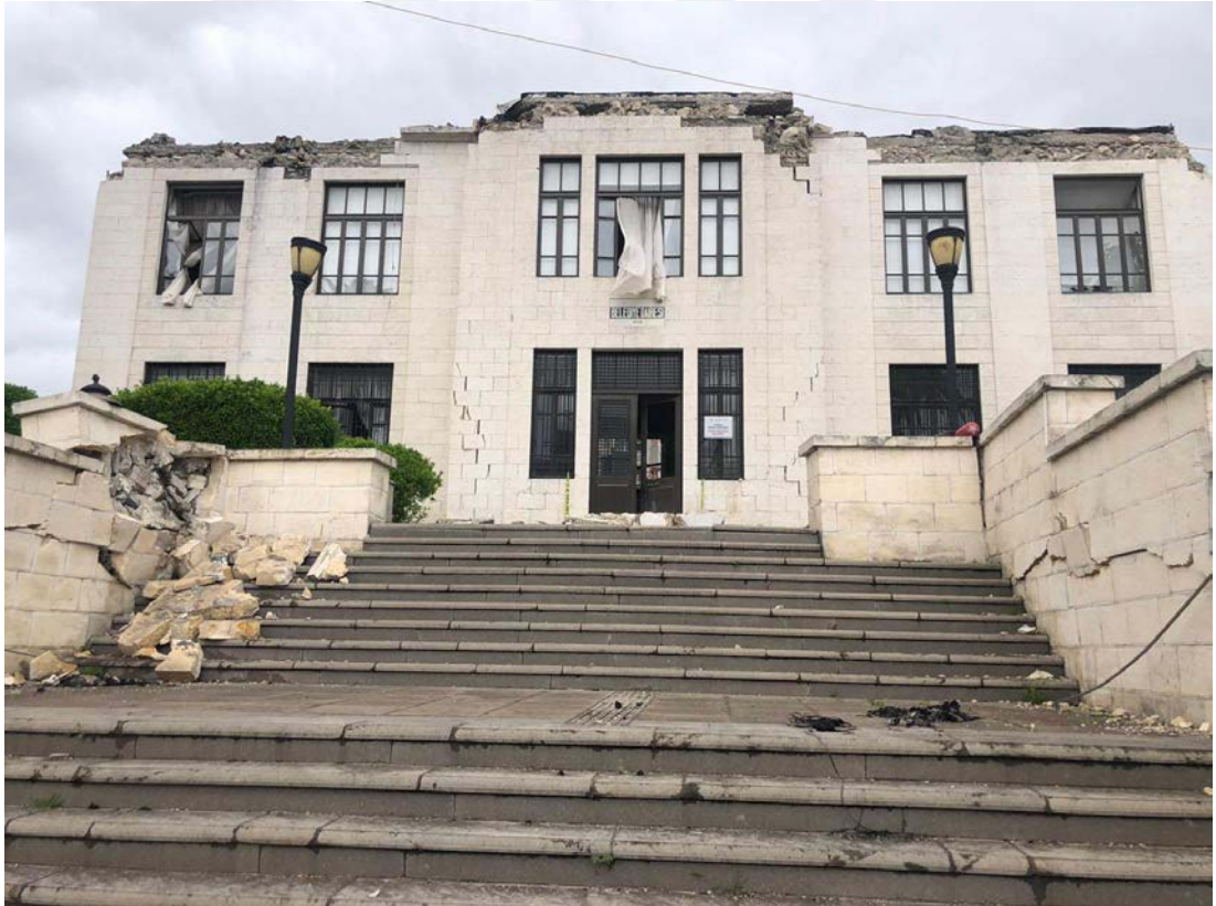
Şekil 6.24: Belediye Binası (Depremden Sonra)
