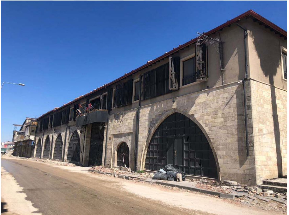
Şekil 6.18: Savon Otel (Depremden Sonra)
