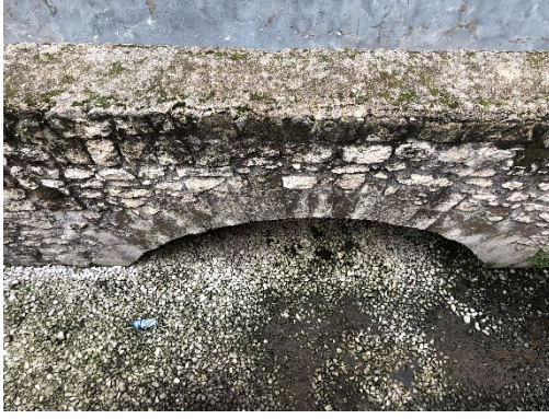
Şekil 6.1: Saray Caddesinde yer alan Su Kemerleri (Depremden Önce)
