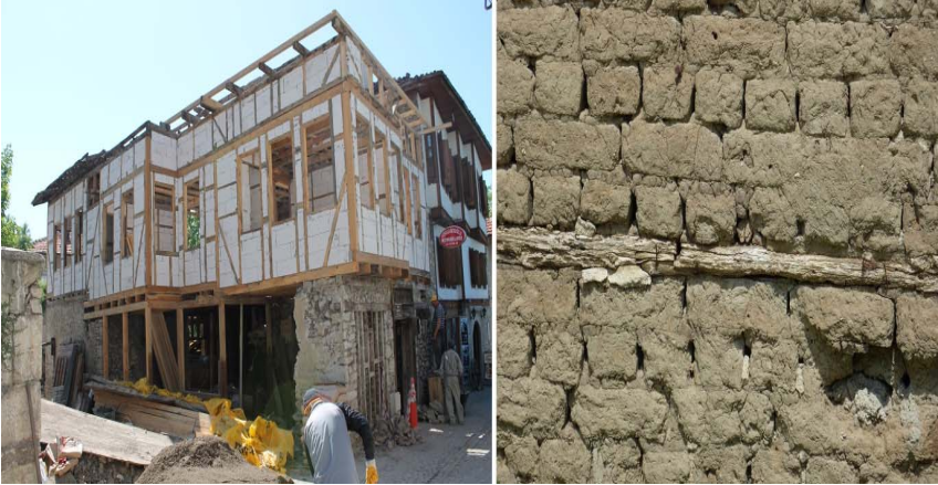
Şekil 13. Solda Safranbolu'da Geleneksel Bir Konutun Restorasyonunda Dolgu Malzemesi Olarak Kerpiç Malzemenin Yerine Endüstriyel Farklı Malzeme Kullanımı, Sağda Özgün Kerpiç Malzeme
