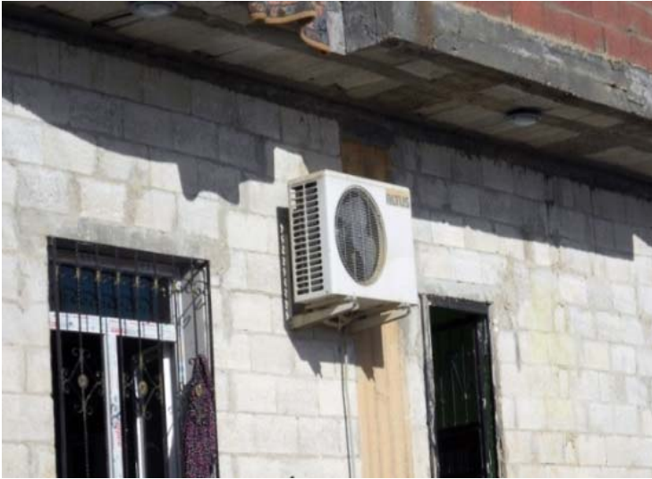
Şekil 9. Mardin Yöresinde Boşluklu Beton Blokla Yapılan Bir Köy Evinde Kullanılan Klima Cihazı. Foto: E. Solhan
