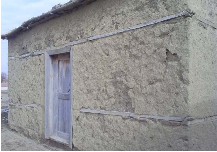
Resim 5. Ankara Bala (2007) Depremi: Kerpiç Yapı Hatıl ile Korunmuş
