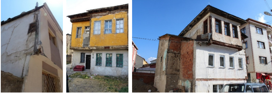
Şekil 26: Sivas geleneksel konutlarının yapı ölçeğinde korunma sorunları (sırasıyla: nitelsiz onarım; özgün açıklıkların kapatılması; yapının özgün yapısına aykırı malzeme kullanımı) (Gülhayat Kılıcı)
