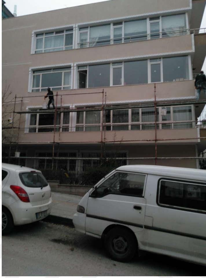
Şekil 32: Ankara’da sokak arasında güvensiz bir iskele uygulaması
