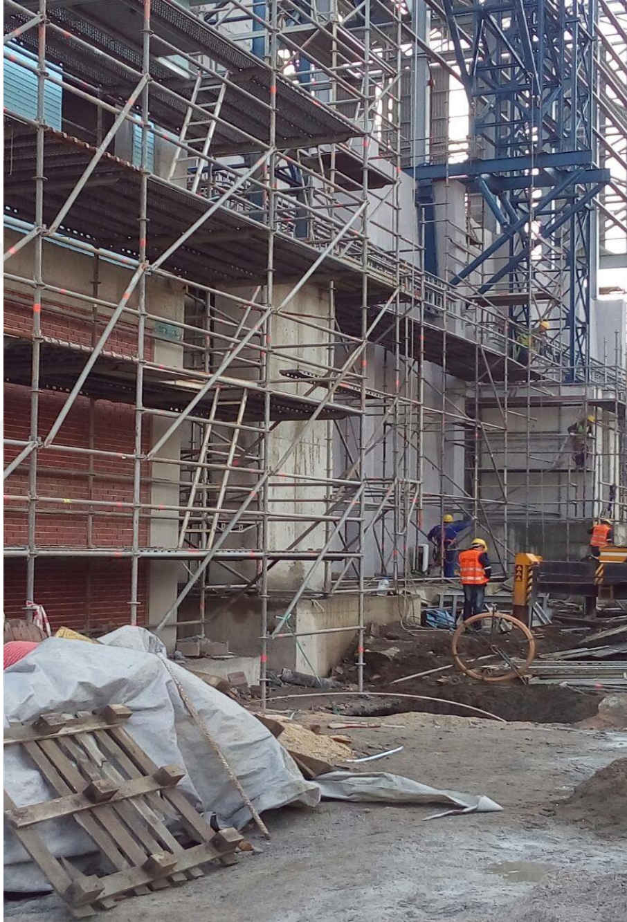
Şekil 31: Sahada kurulumu tamamlanmış ve kontrol listesine göre incelendiğinde uygunsuzluk bulunan iskele.
