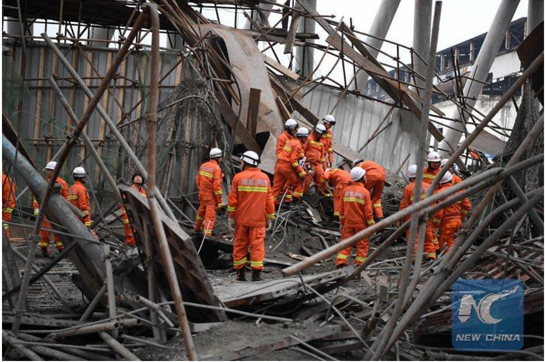
Şekil 2: Çin’ de enerji santrali yapımı esnasında kurulmuş iskelenin çökmesi sonucu meydana gelen iş kazası
