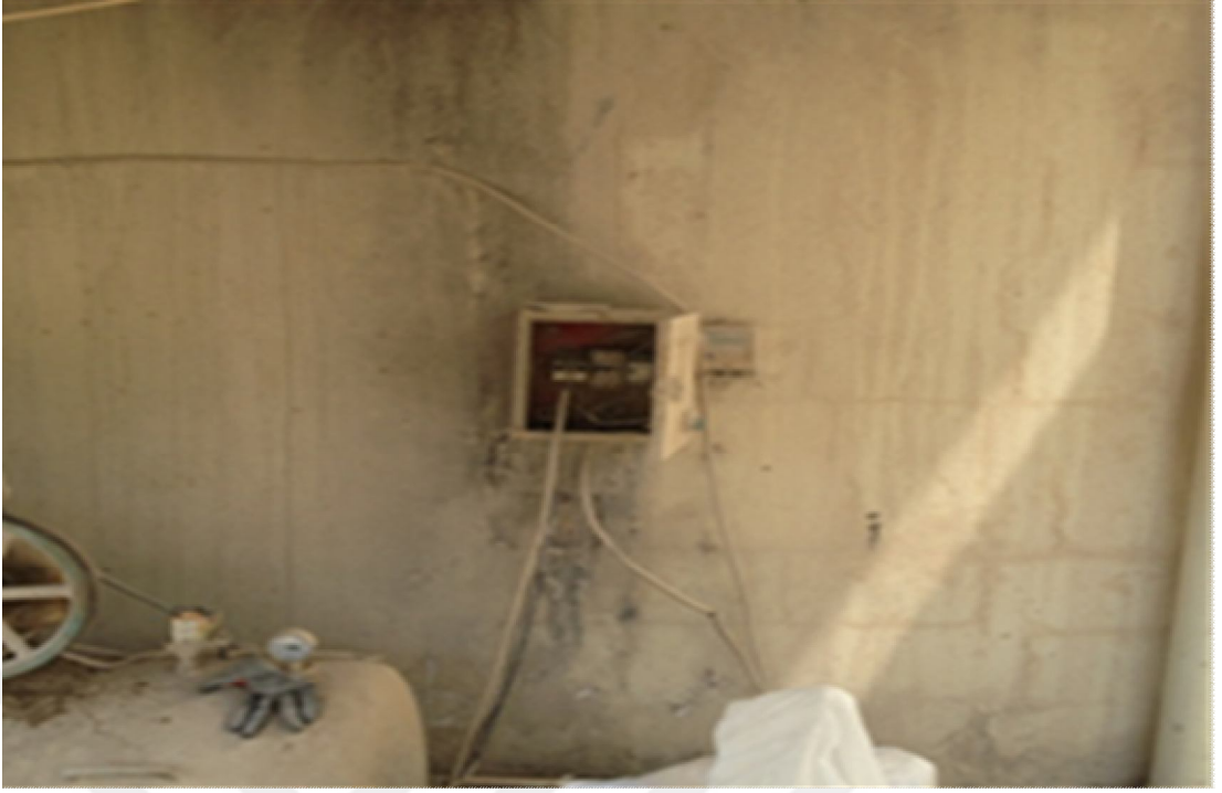
Şekil-25: İşletmedeki açık uçlu kablolar
