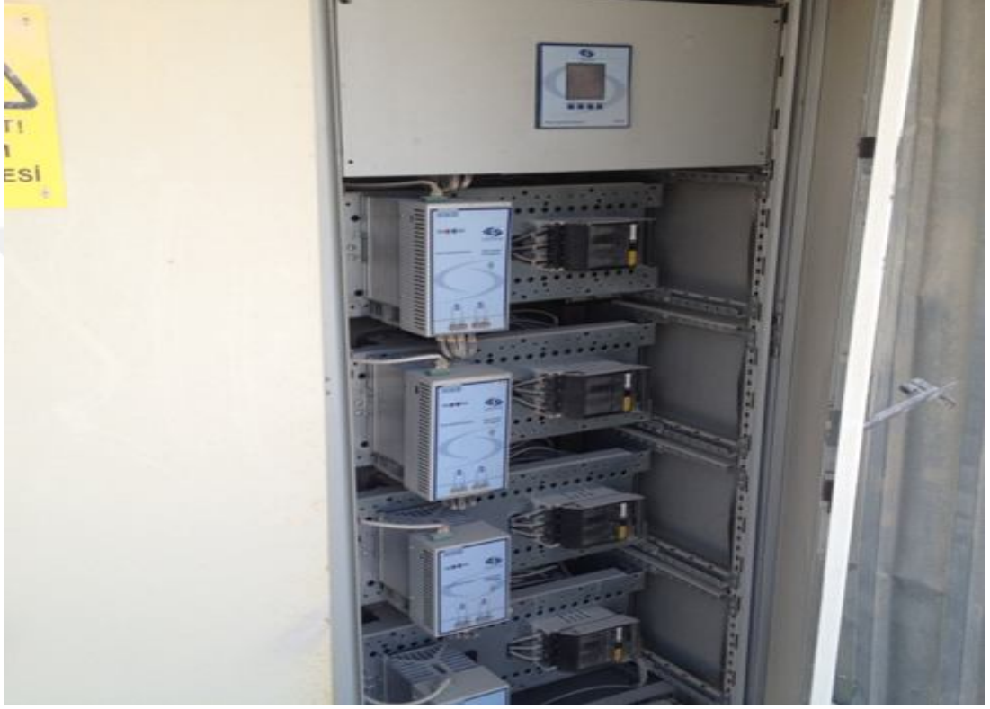
Şekil-22: İşletmedeki elektrik tesisatı
