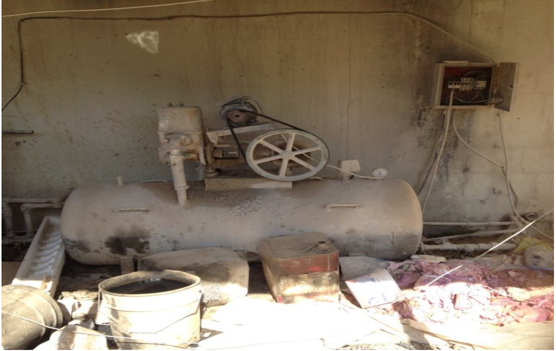
Şekil-26: İşletmedeki hava tankı
