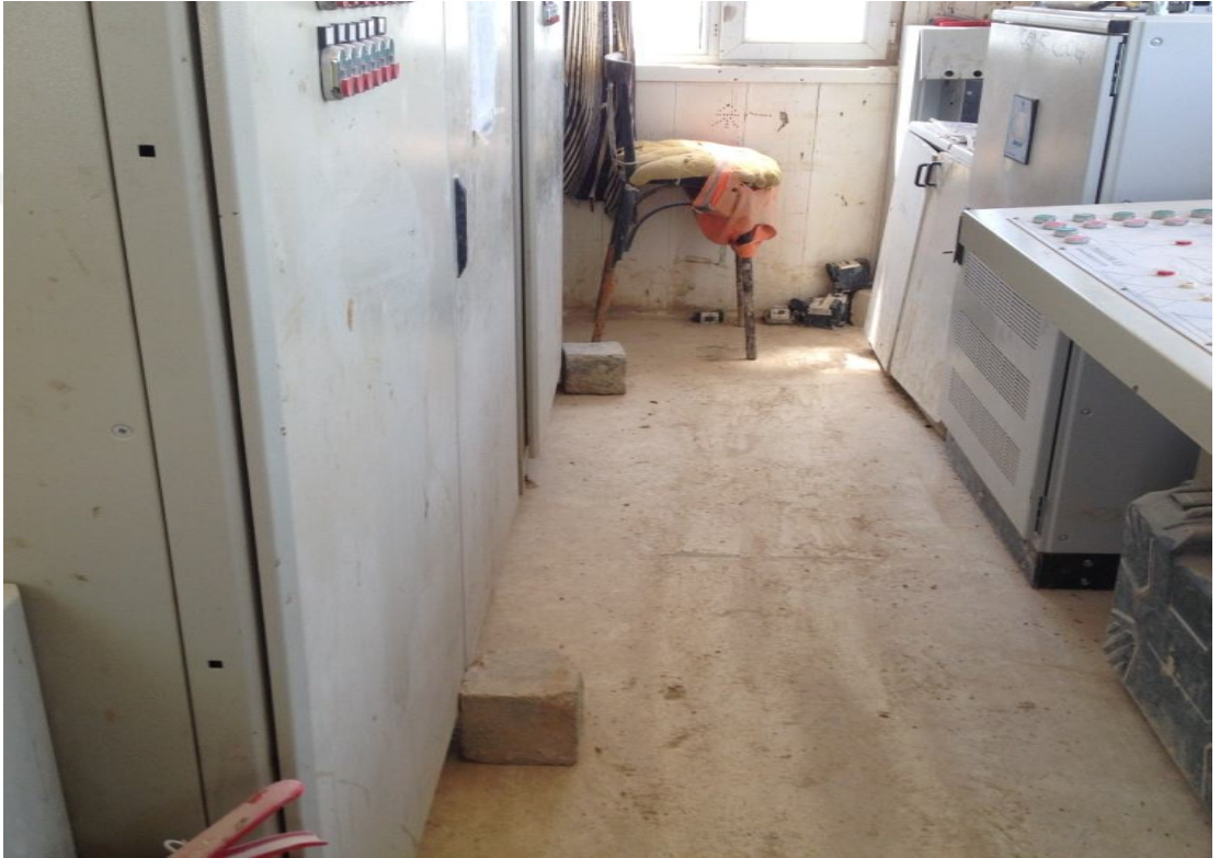
Şekil-23: İşletmedeki elektrik panoları
