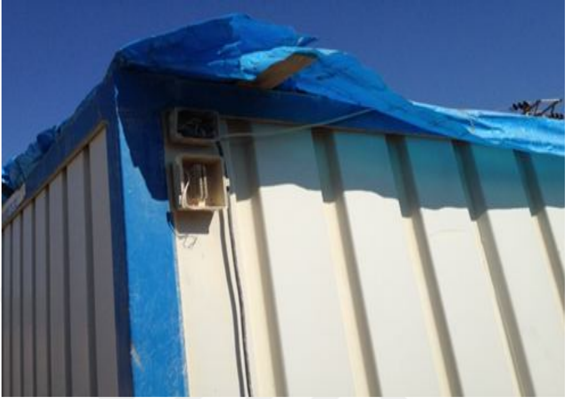
Şekil-24: İşletmedeki açık iletkenler
