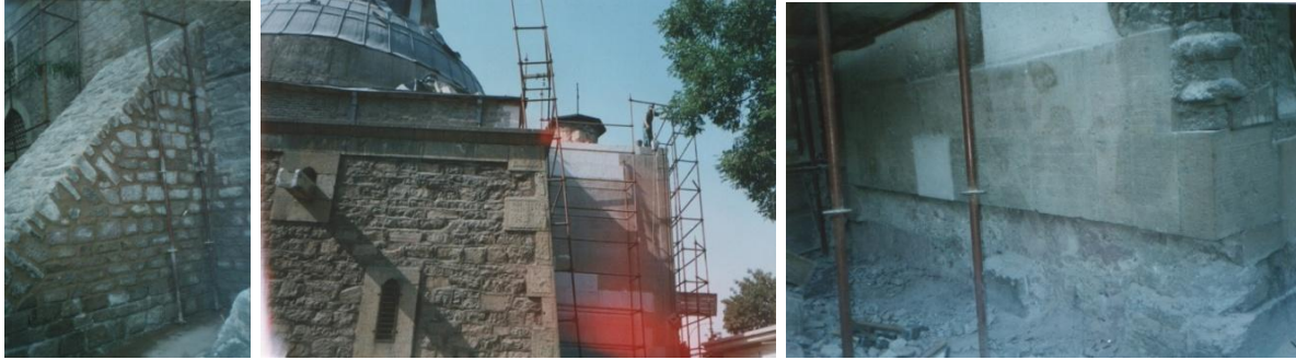
Resim 2.25. Eyvan duvarındaki destek payandada derz yenilenmesi (solda), taç kapı güney cephesinde taş malzeme yenilenmesi (orta), taç kapı güney cephesi alt kısmında taş çürütme (sağda) (KRAM Arşivi)
