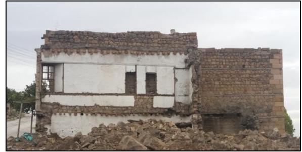
Resim 8. Yağdan Mahallesi- Bekir Özel Sokağı'nda Yer Alan Bir Kısmı Yıkılmış Olan Geleneksel Yapının Malzeme Detayları
