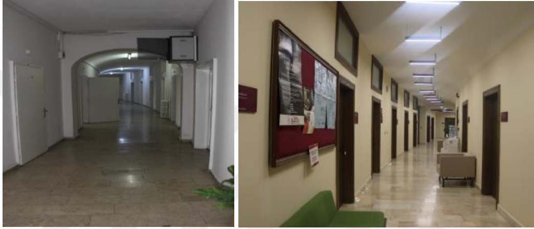
Resim 109: Restorasyon Öncesi ve Sonrası, İkinci Kat Hol (Şen, A. 2019)
