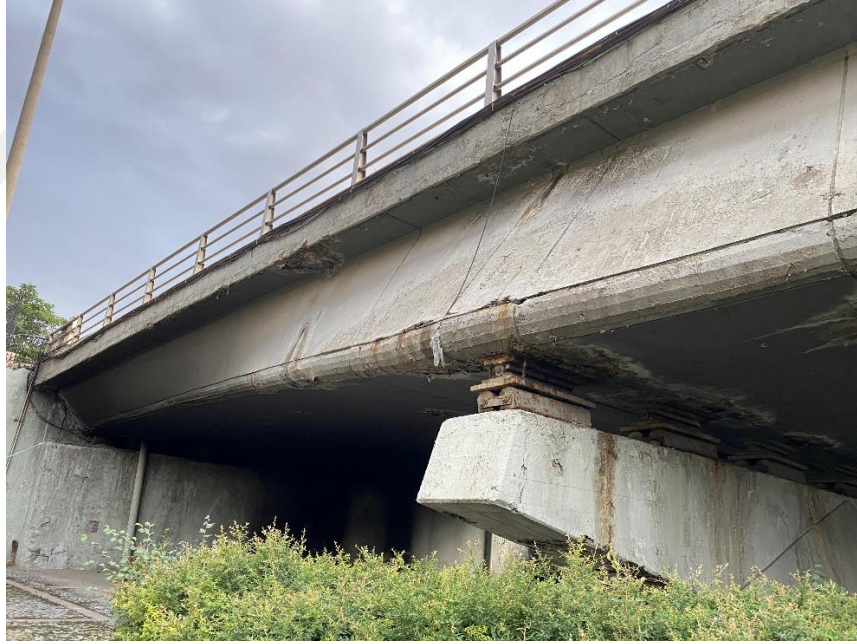
Şekil 6. 16: Sızıntılardan kaynaklı yüzeydeki lekeler (Okumuş, 2021)
