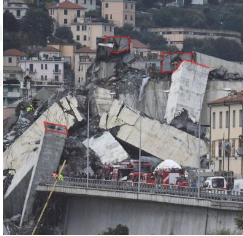
Şekil 4. 34: Yıkılan Morandi Köprüsü (Bazzucchi, 2018)
