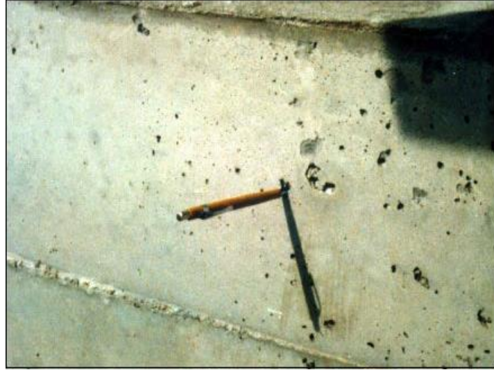
Şekil 4. 4: Beton yüzeyinde oluşan boşluklar (Akakın ve Engin, 2010)
