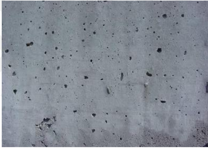
Şekil 4. 5: Beton yüzeyinde oluşan boşluklar (url-19)
