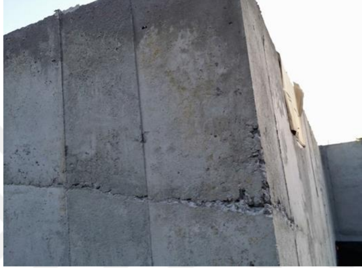
Şekil 4. 7: Soğuk derz görünümü (Dikmen, 2018)
