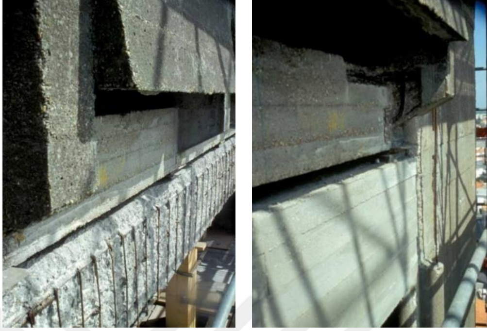
Şekil 4. 25: Karbonatlaşma, parça kopmaları görülen beton yüzey ve onarımı (Barbot, 2019)
