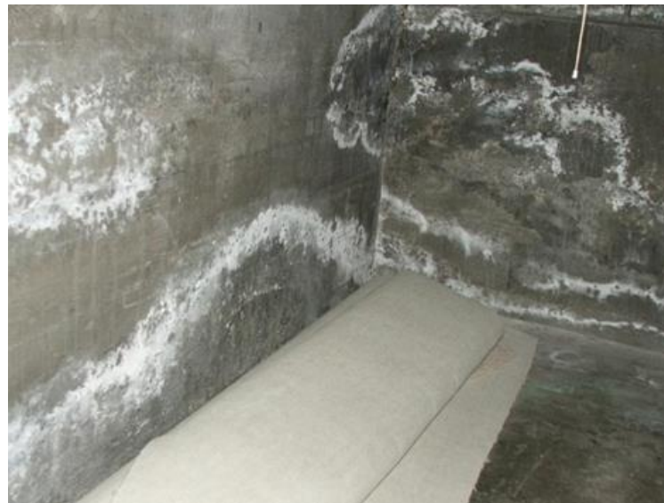
Şekil 4. 10: Betonda çiçeklenme (Dikmen, 2018)
