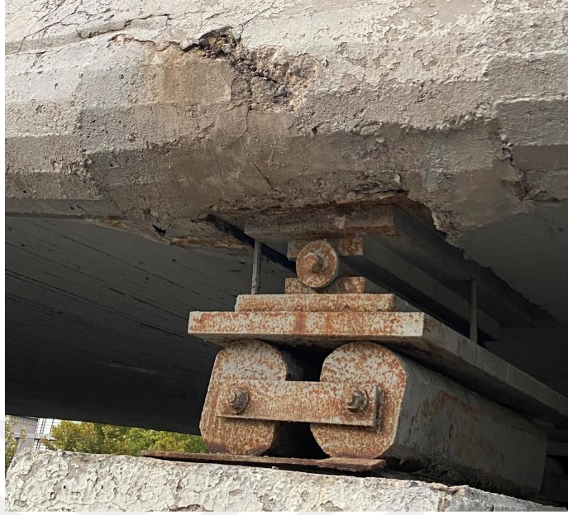
Şekil 6. 17: Yapı elemanlarında paslanma (Okumuş, 2021)
