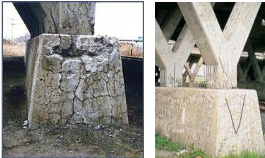
Şekil 4. 14: Beton yüzeylerinde ağ biçiminde kılcal çatlaklar (Akakın ve Engin, 2010)
