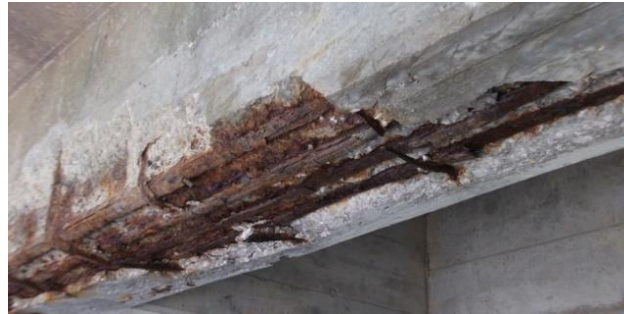
Şekil 4. 11: Betonda yüzey kopması görünümüleri (url-20)
