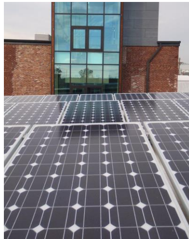
Şekil 20: Çatıda Bulunan Güneş Panelleri (Archinect 2021)
