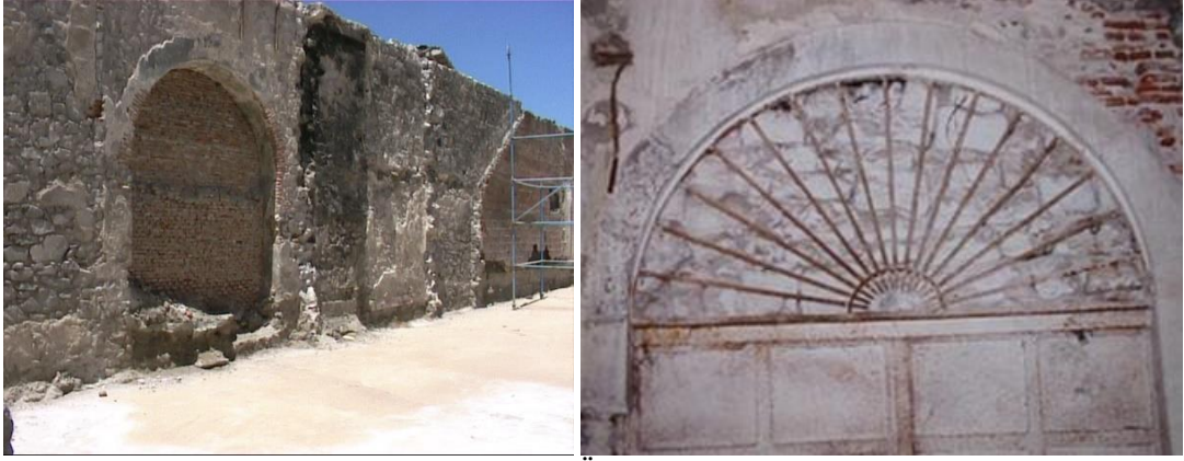
Şekil 38: Yapıda Restorasyon Öncesinde Açıklıklardaki Durum (MATU Mimarlık Arşivi 2022)
