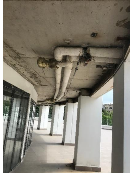
Şekil 5.123: Arkadlı geçiş tavanında ve mekanik tesisat yalıtımında bozulmalar (Nalçacıoğlu, 2022)
