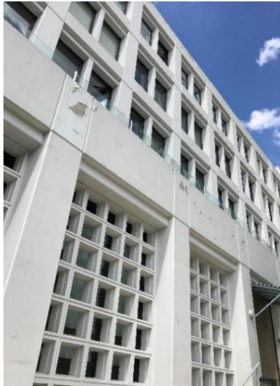
Şekil 5.122: Cephede boya ve sıva dökülmeleri (Nalçacıoğlu, 2022)
