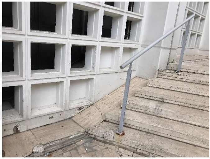
Şekil 5.125: Güney yönü yaya yolunda deformasyon ve korozyon (Nalçacıoğlu, 2022)
