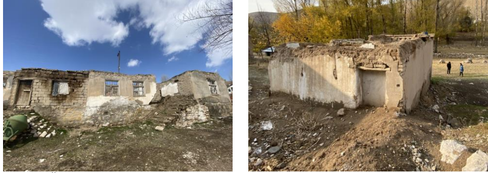
Şekil 4.5: Çatı Örtüleri Tamamen Yok Olmuş Yapılar (3 ve 4 Numaralı Yapılar) (Kişisel Arşiv, 2022)
