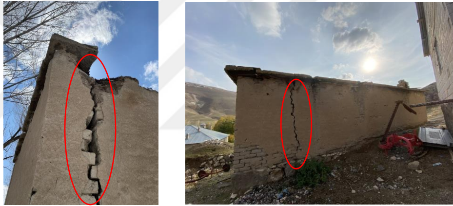
Şekil 4.8: Duvarlarda Meydana Gelen Yapısal Çatlaklar (Kişisel Arşiv, 2022)
