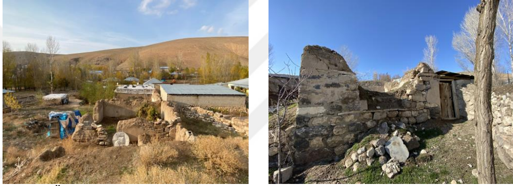
Şekil 4.6: Çatı Örtüleri Tamamen Yok Olmuş Yapılar (14 ve 16 Numaralı Yapılar)(Kişisel Arşiv, 2022)
