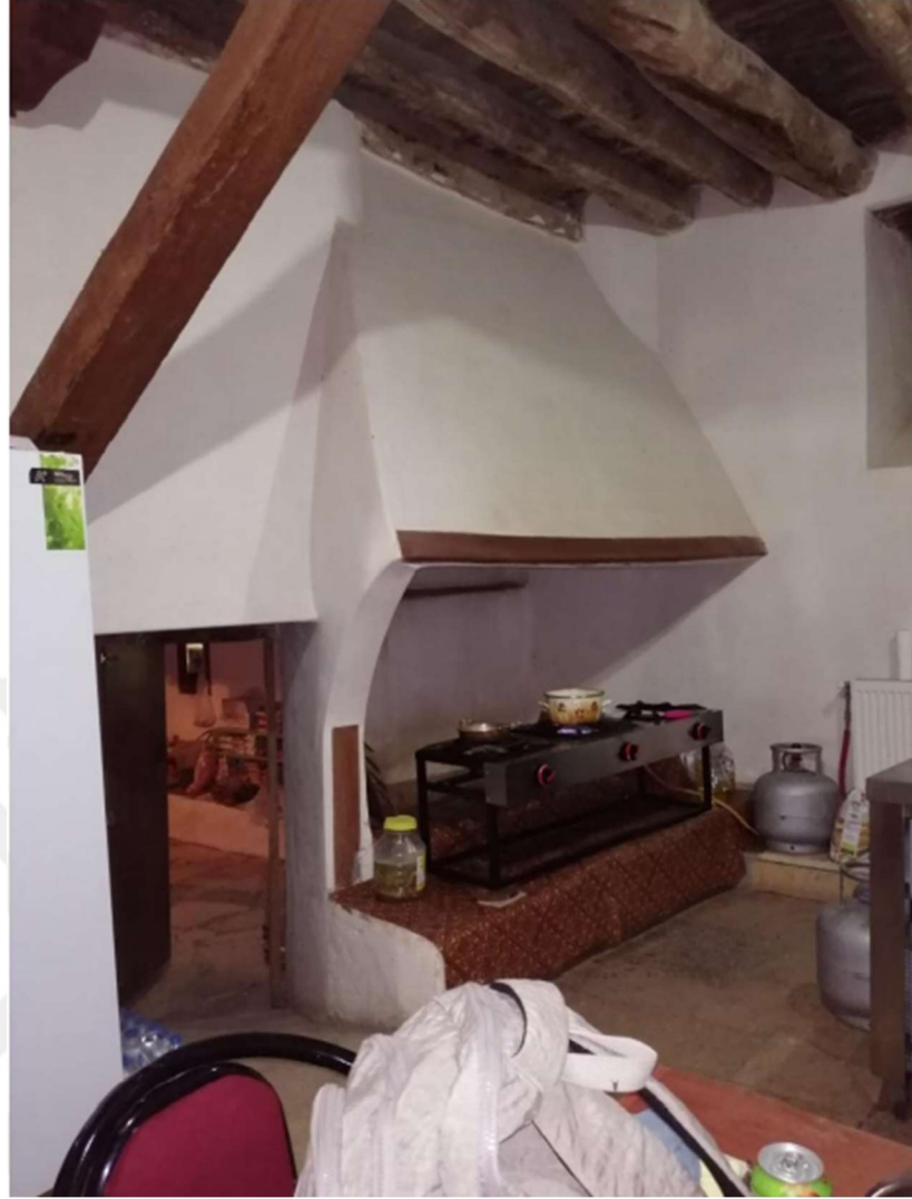
Şekil 2.45: Mühürzade Konağı Yıkılan Ocak
