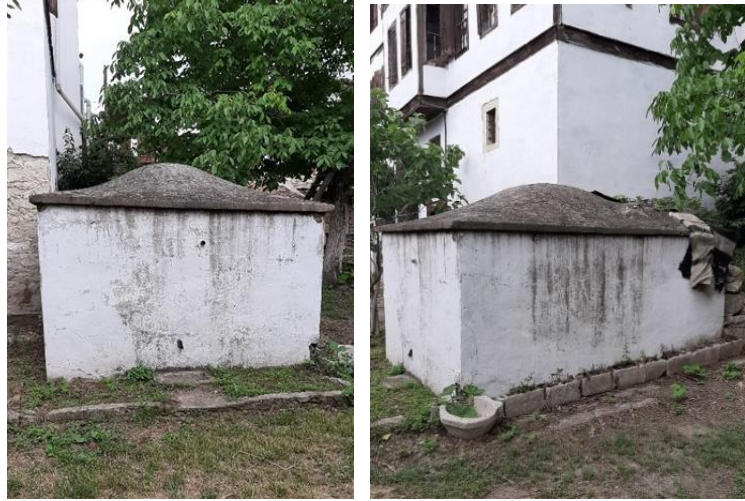
Şekil 22: Erciyes Konağının bahçesinde yer alan yağmur suyu deposu (Kahyaoğlu 2021).
