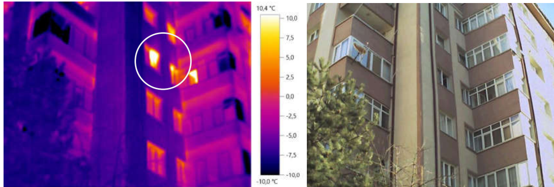
Şekil 3.5: İç havalandırmanın sağlanması için kullanıcı tarafından açılmış pencerelerden kaynaklı ısı kaybı
